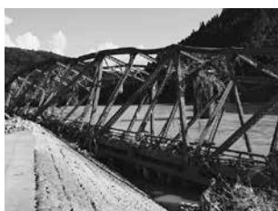
令和2年7月豪雨の災害調査
