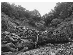
土石を捕捉した土石流対策工
